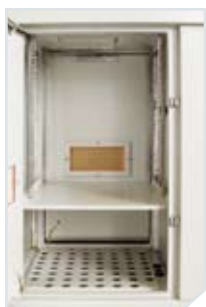
Телекоммуникационный отсек Отсек питания
